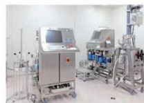
大型クロマトシステム
